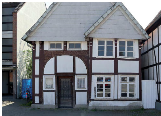
Deutlicher Sanierungsbedarf (Widumstraße)
