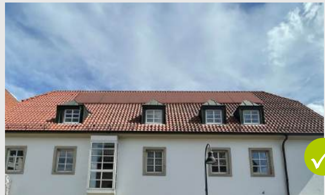
Rote PV-Module bilden eine zusammenhängende Rechteckfläche und erzeugen eine ruhige Dachlandschaft
