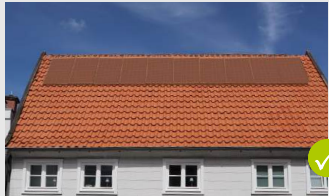
Rote PV-Module fügen sich gut in eine rote Dachlandschaft ein
