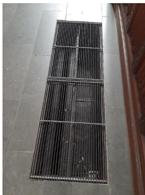
Abbildung 8: Warmluftheizung (Foto: BA)
